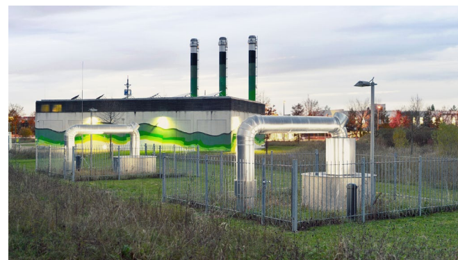
Aardwarmtecentrale in München. (operationele fase) (foto: SWM/Thomas Einberger)
